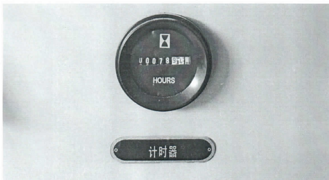
照片 D5 氧压机运转检查
